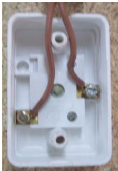
Detalle de la conexión de un interruptor
